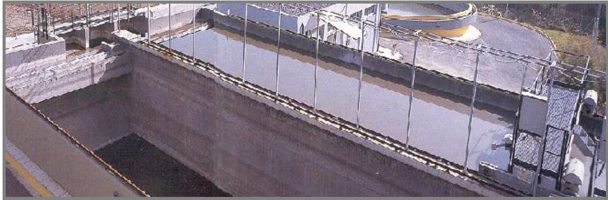
Σχήμα 4.7: Δεξαμενές πρωτοβάθμιας καθίζησης Ε.Ε.Λ. Χερσονήσου
