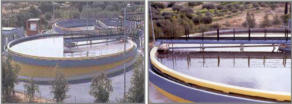
Σχήματα 4.10, 4.11: Δεξαμενές δευτεροβάθμιας καθίζησης Ε.Ε.Λ. Χερσονήσου
