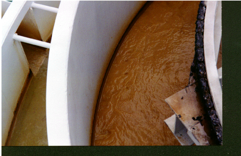
Εικόνα 7. Το νερό αναμιγνύεται με χλωριούχο σίδηρο και οξείδιο του ασβεστίου και στη συνέχεια ακολουθεί η κροκίδωση. ( http://www-ceg.eng.ohio-state.edu/~hwalker/CE812_Web/CE812_Tour.htm )
