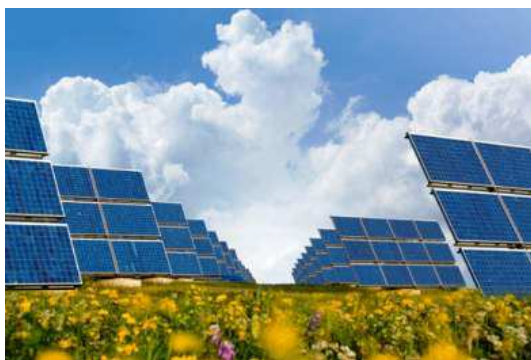
(φωτοβολταϊκό πάρκο 80 KW στο νομό Λασιθίου).
