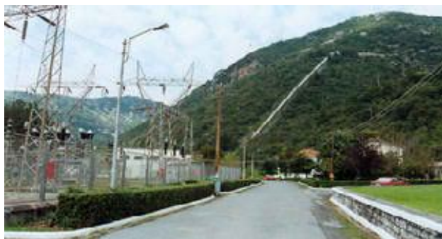
Εικόνα 9: Εγκατάσταση εκμετάλλευσης υδατόπτωσης
