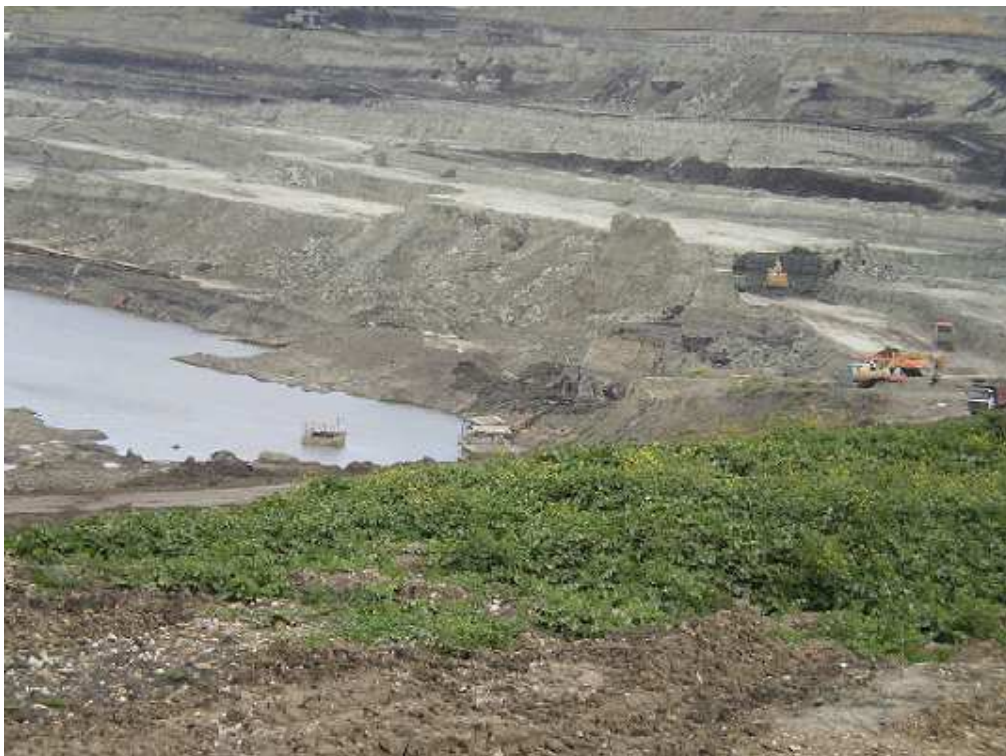
Εικόνα 4: Αντλιοστάσιο στο ορυχείο της Μεγαλόπολης και στο βάθος δεξιά η εξόρυξη του λιγνίτη με την εμφανή παρατήρηση των πρανών.
