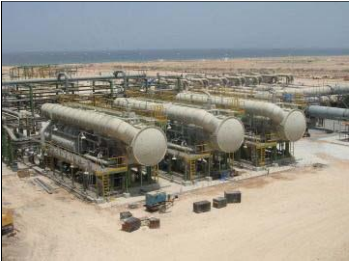
Εικόνα 5.2: Εγκατάσταση πολυβάθμιας εξάτμισης στο Ομάν (3 x 2400 m 3 /ημέρα) [27]
