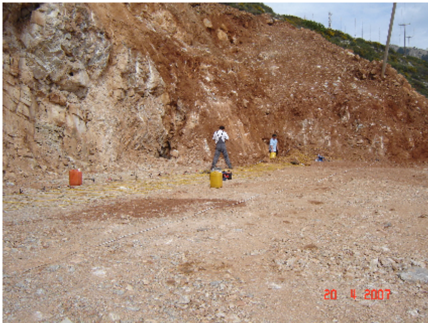
Φωτογραφία 8. Στη φωτογραφία απεικονίζεται το τέλος της πρώτης διασκόπησης καθώς και οι 2 πρώτες εμφανίσεις εγκοίλων εντός του χώρου διαμόρφωσης για τη θεμελίωση.
