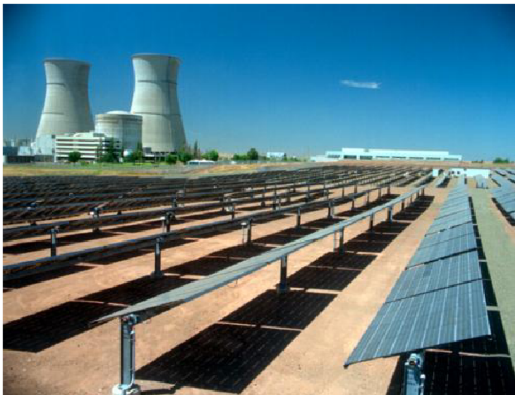
Σχήμα 8: Συστοιχία Φ/Β πλαισίων σε εργοστάσιο για παραγωγή ενέργειας
