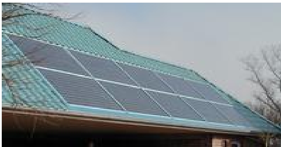
Σχήμα 15: Φωτοβολταϊκά σε σκεπή σπιτιού
