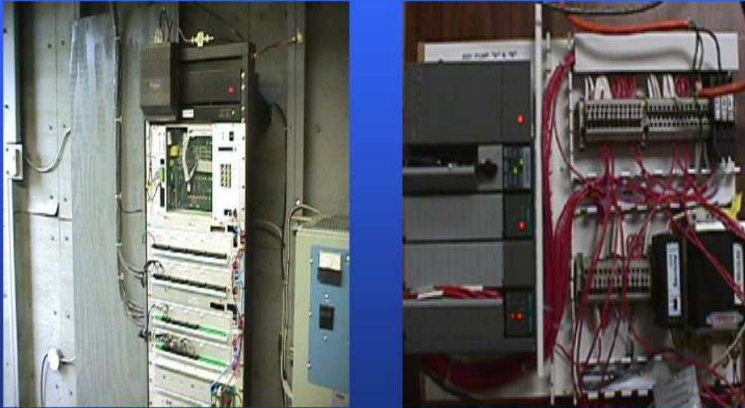
Εικόνα 1 Εσωτερική Εγκατάσταση RTU
