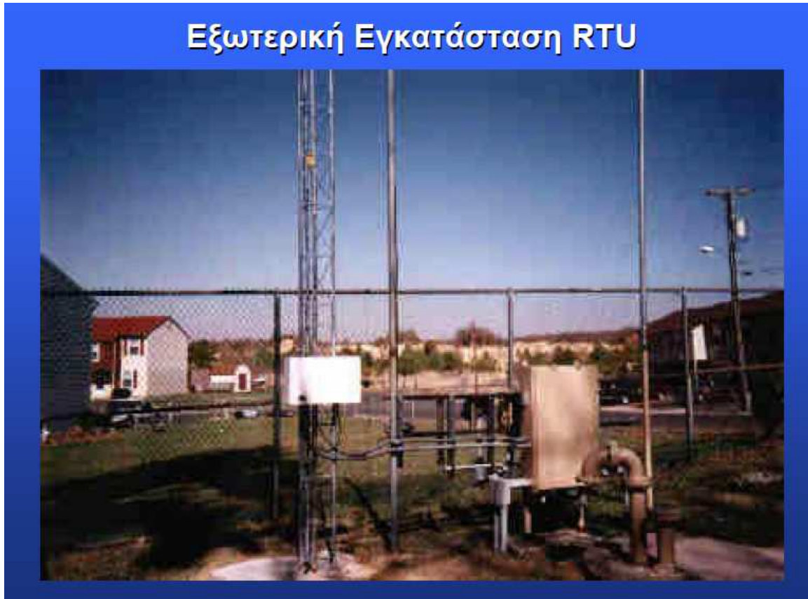
Εικόνα 2 Εξωτερική Εγκατάσταση RTU
