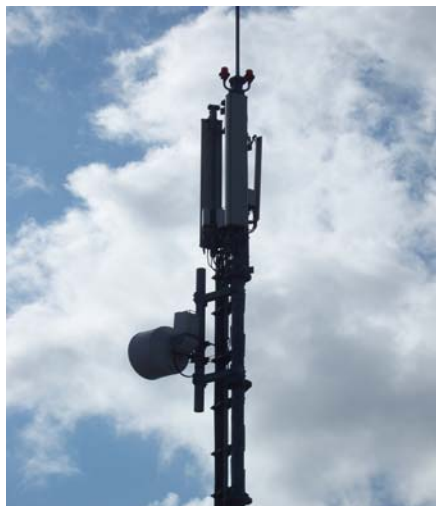
Το κεραιοσύστημα του σταθμού βάσης T/K 6081 της Cosmote
