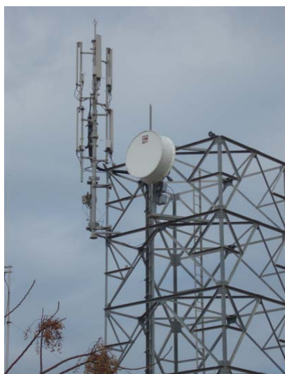
Το κεραιούστημα στο οποίο είναι αναρτημένος ο σταθμός βάσης της COSMOTE
