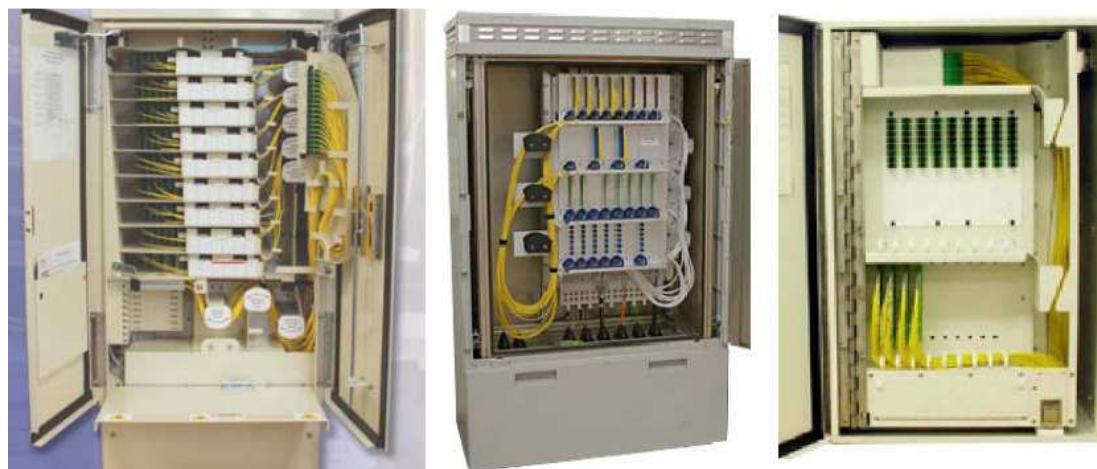
Σχήμα 38 Υπαίθριες καμπίνες εγκατάστασης παθητικού εξοπλισμού για χρήση σε έργα FTTB/H.
