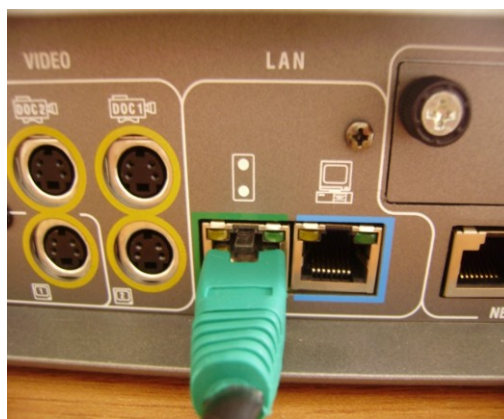
Εικόνα 21: Σύνδεση καλωδίου δικτύου
