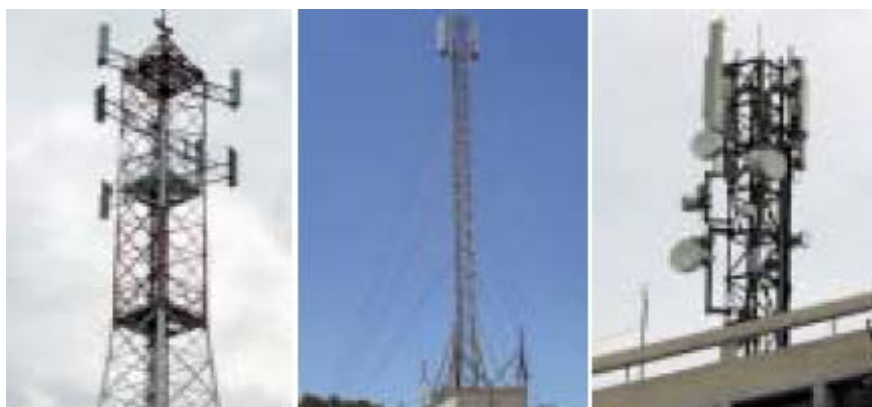
Σχήμα 2 ο : Τυπικοί Σταθμοί Βάσης
