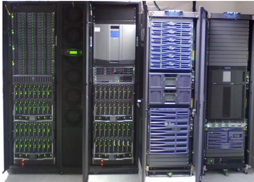
Εικόνα 2.3. Εξυπηρετητές (servers) σε ένα server room
