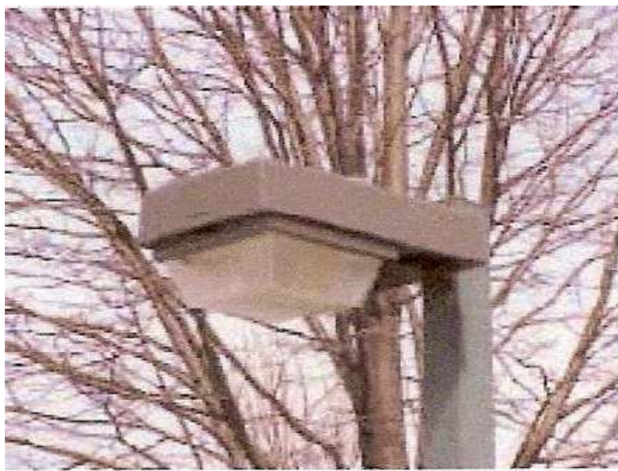
Εικόνα 7-5: Φωτιστικό σώμα χώρου στάθμευσης
