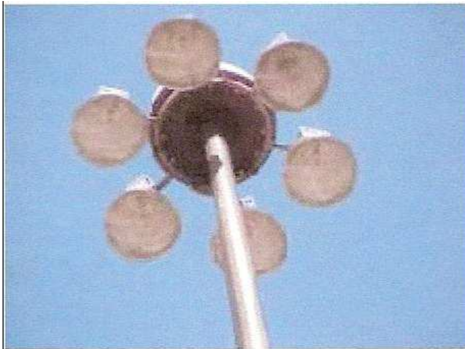
Εικόνα 7-4: Φωτιστικά σώματα υψηλού ιστού
