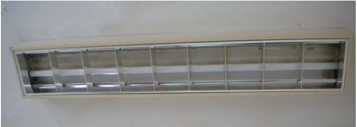
Εικόνα5. 10: Φωτιστικό χαμηλής αντανάκλαστικότητας με λαμπτήρες τύπου T8
