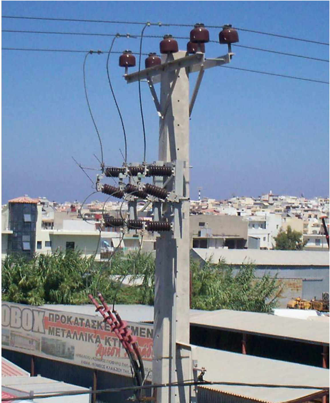
Τριπολικός αποζεύκτης (σύνδεση με υπόγειο καλώδιο Μ/Τ)
