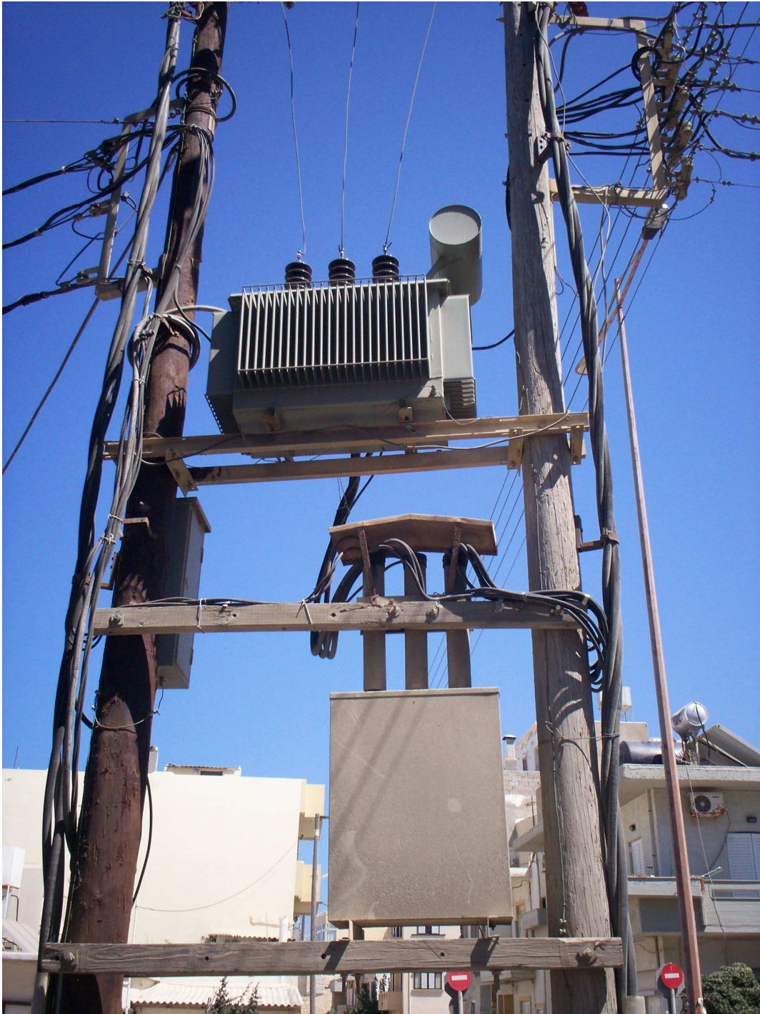
Υποσταθμός υποβιβασμού μέσης τάσης σε χαμηλή τάση
