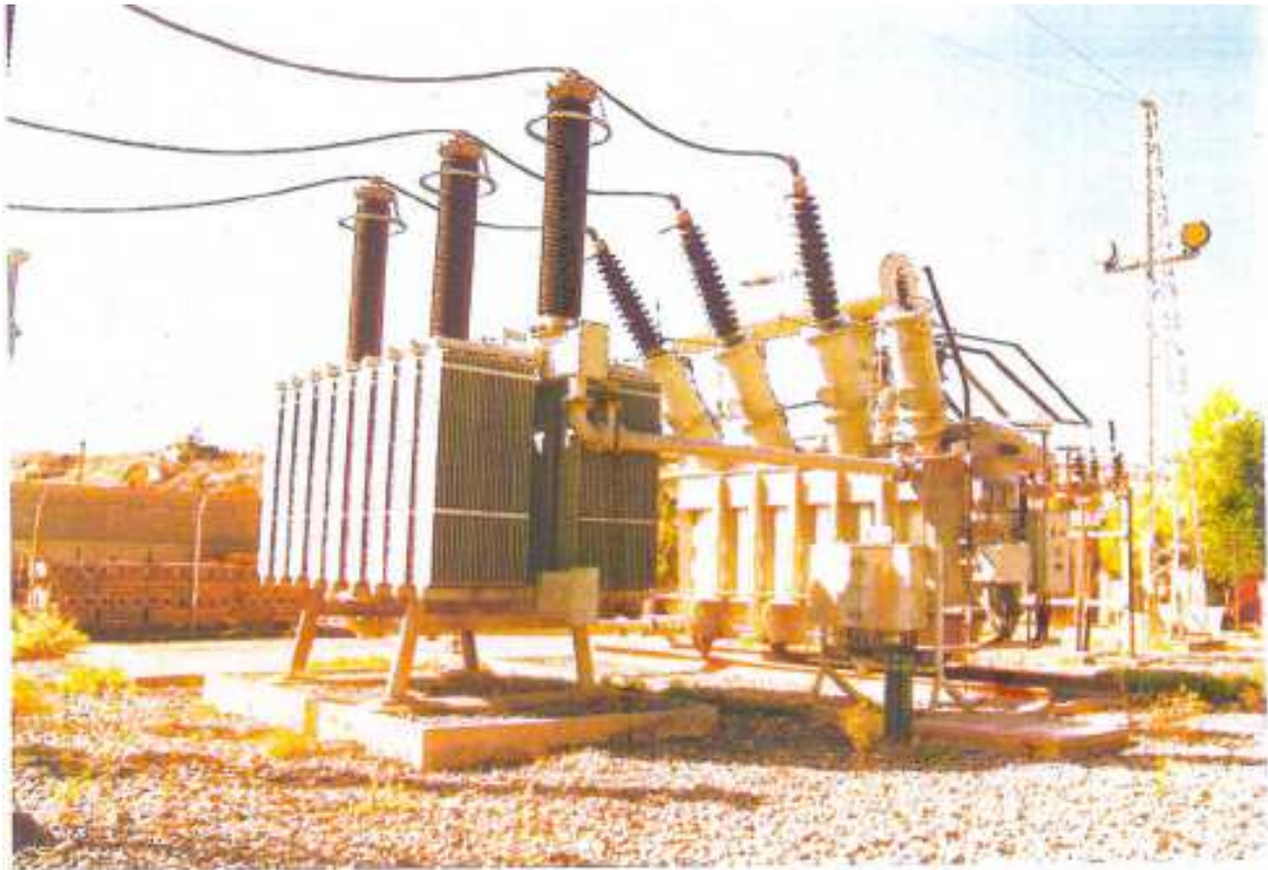
Μ/Σ Υψηλής τάσης σε Μέση τάση
