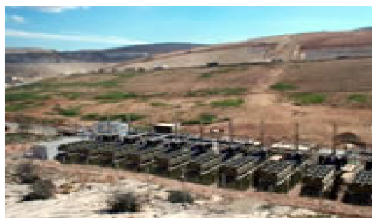
Εικόνα 29: Συμπαράγωγή ηλεκτρικής και θερμικής ενέργειας στο ΧΥΤΑ Άνω Λιοσίων <biofuels.gr>
