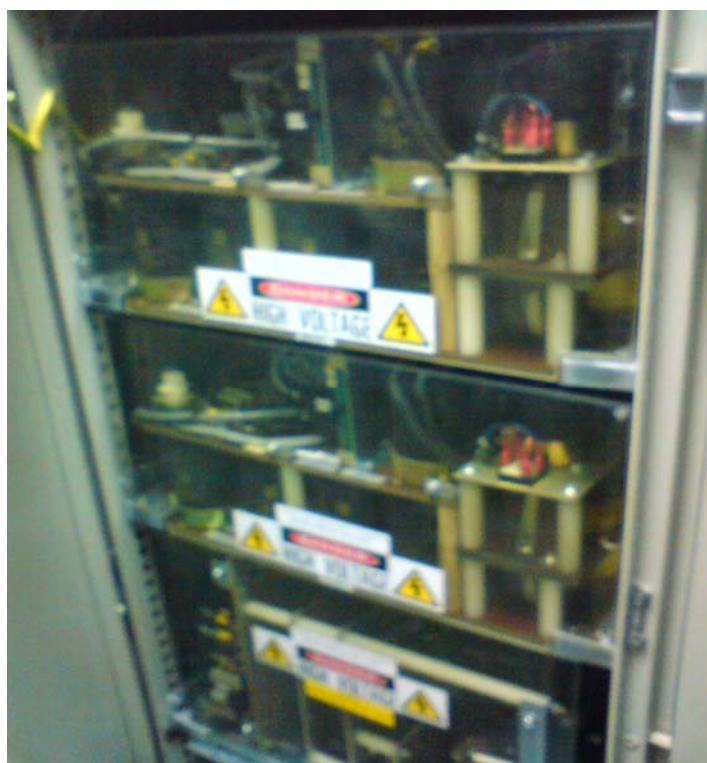
Σχήμα 4.7 Εσωτερικό μονάδας παροχής ηλεκτρικής ισχύος
