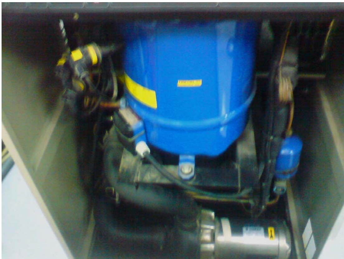
Σχήμα 4.3 Εσωτερικό μονάδας ψύξης
