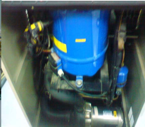
Σχήμα 9.2 Εσωτερικό ψυκτικού μηχανήματος
