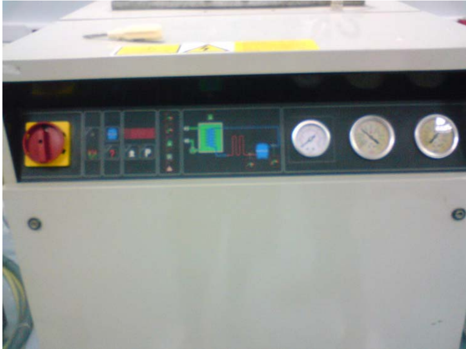
Σχήμα 4.4 Πρόσοψη ψυκτικής μονάδας
