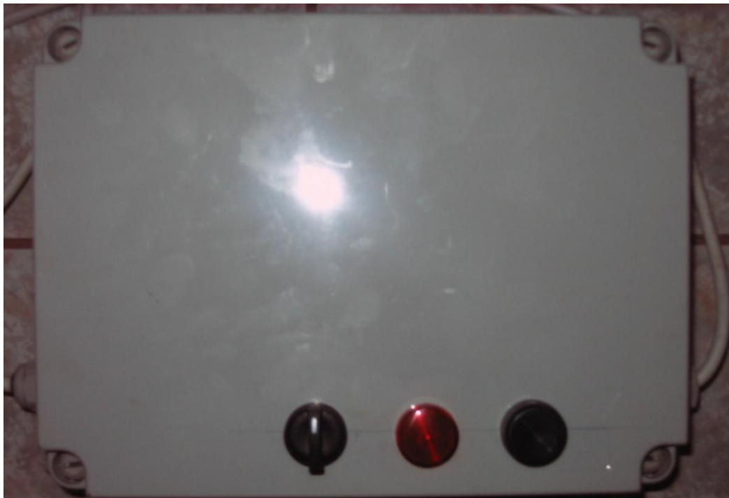
Εικόνα 12. Πίνακας τροφοδοσίας. Περιλαμβάνει μετασχηματιστή για γαλβανική απομόνωση και τους απαγωγείς υπερτάσεων.
