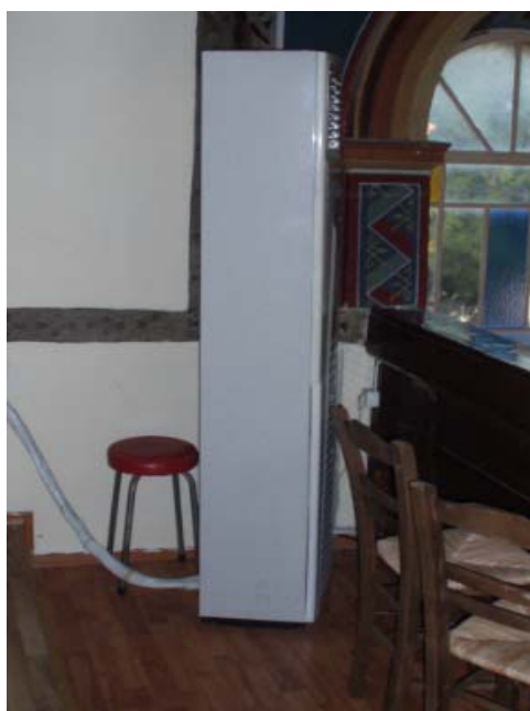
Εικόνα 56 : Το κλιματιστικό μηχανήμα του Ιερού Ναού.
