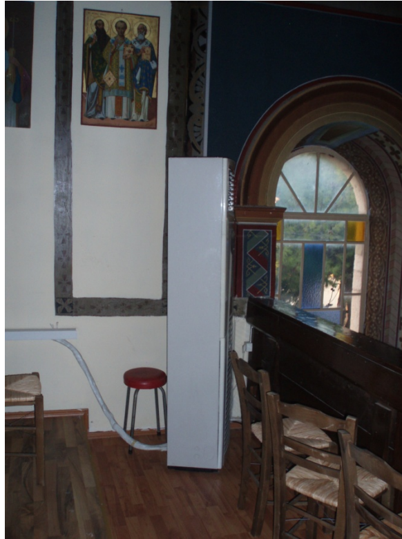
Εικόνα 44: Κλιματιστικό σε ενοριακό ναό, το συγκεκριμένο με ισχύ 5.000 Watt.
