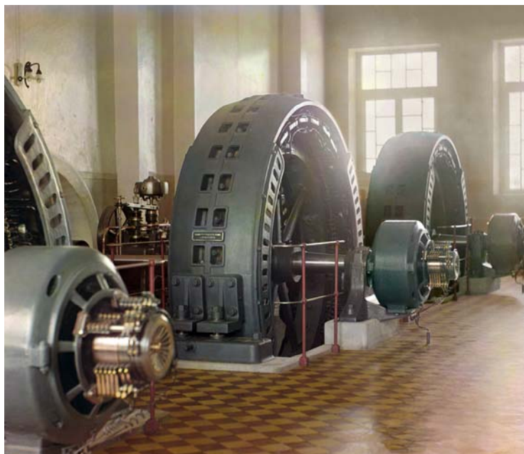
Σχ. 1.2 Σύγχρονες γεννήτριες σε σταθμό παραγωγής
