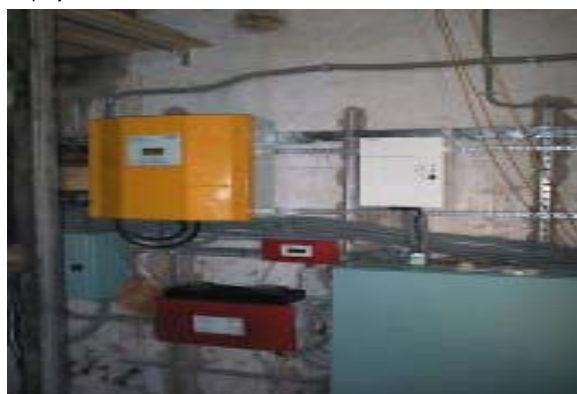
Εικ. 6-6 Μονοφασικό φ/β σύστημα στη Λαντάκ
