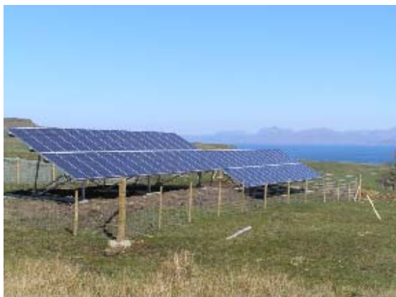
Εικ. 8-10 10 kWp φωτοβολταϊκής συστοιχίας (τον Σεπτέμβριο / Οκτώβριο του 2010 εγκαταστάθηκαν επιπλέον 22 kWp)
