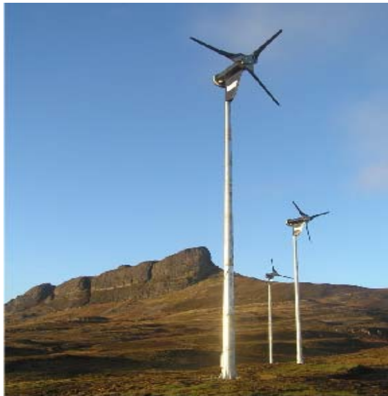
Εικ. 8-9 6kW ανεμογεννήτριες που βρίσκονται στο νότιο τμήμα της Eigg.
