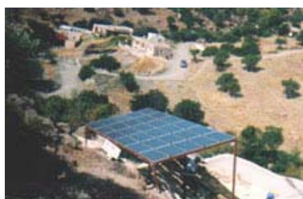
Εικ. 8-30Αυτόνομο φ/β σύστημα στο ‘Μέγα Ποταμό’
