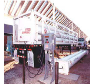
Αποθήκευση αερίου υδρογόνου σε συστοιχίες κυλίνδρων
