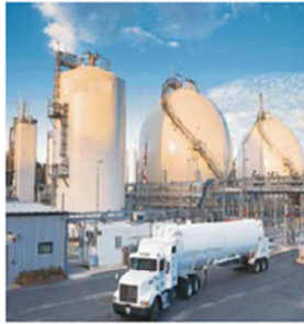
Δεξαμενή αποθήκευσης αερίου υδρογόνου σε χαμηλή πίεση
