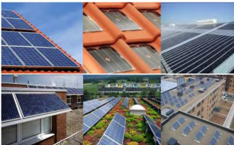
Εικόνα 3-30: Εγκατεστημένες Φ/Β συστοιχίες με σταθερή γωνία κλίσης
