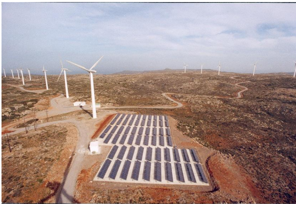
Εικόνα 5-32: Φ/Β Σταθμός συνολικής εγκατεστημένης ισχύος 172 kWp της ΡΟΚΑΣ ΑΙΟΛΙΚΗ ΑΒΕΕ στο Νομό Λασιθίου
