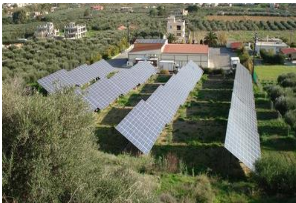
Εικόνα 5-33: Φ/Β Σταθμός συνολικής εγκατεστημένης ισχύος 135 kWp στο Νόμο Ηρακλείου
