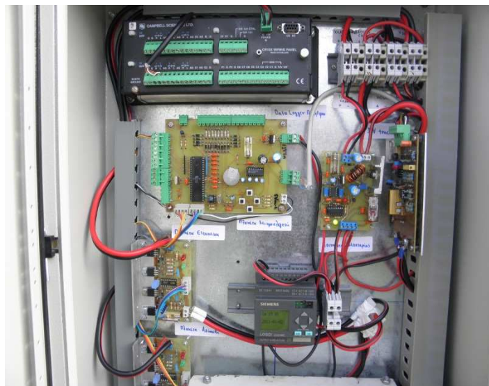
Εικ. 3.2.2.2 Ο ηλεκτρικός πίνακας
