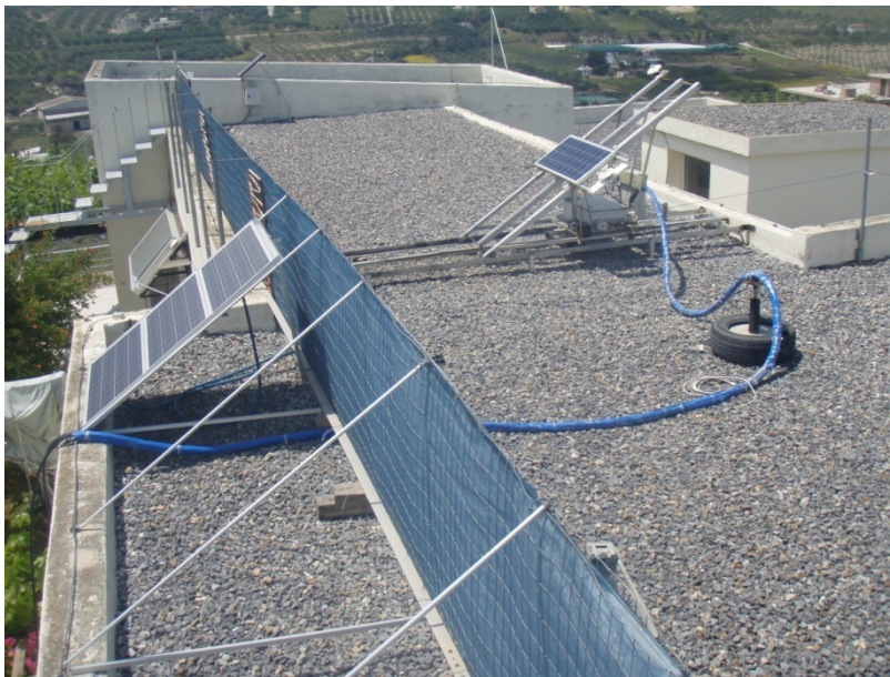
Εικόνα 3.1 Χώρος εγκατάστασης της διάταξης (Ανατολική λήψη)
