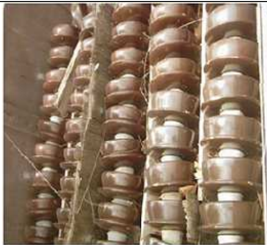
Σχήμα 1.15.β. Πορσελάνινοι μονωτήρες τύπου ομίχλης 150 kV.
