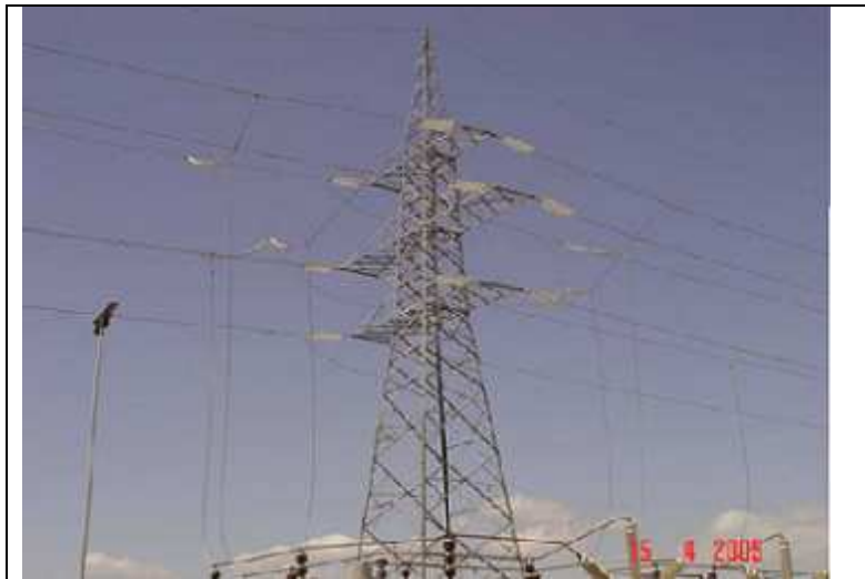
Σχήμα 1.8. Γυάλινοι μονωτήρες σε τερματικούς πυλώνες
