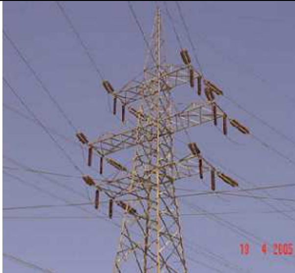
Σχήμα 1.18 Πορσελάνινοι μονωτήρες σε πυλώνες διέλευσης
