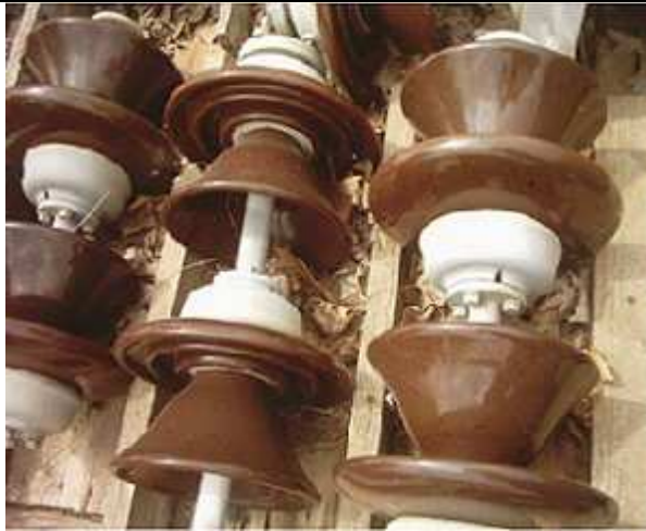
Σχήμα 1.17 Πορσελάνινοι μονωτήρες στηρίξεως ζυγών 66kV.
