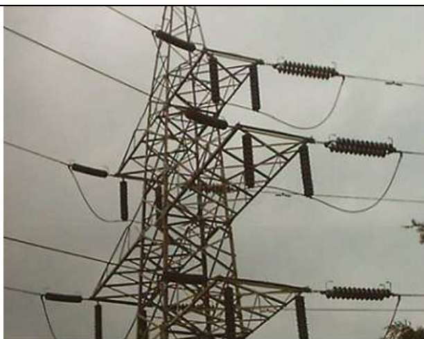
Σχήμα 1.19 Πορσελάνινοι μονωτήρες σε πυλώνες
