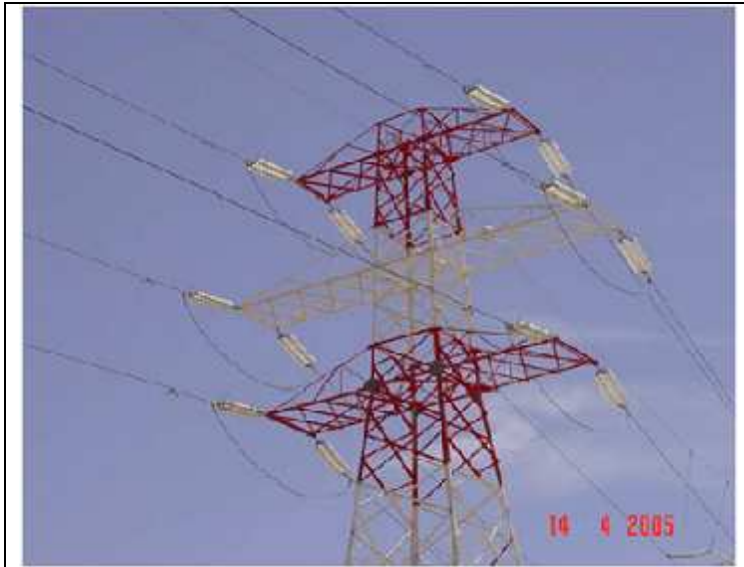
Σχήμα 1.13 Γυάλινοι μονωτήρες σε πυλώνα αεροδρομίου.
