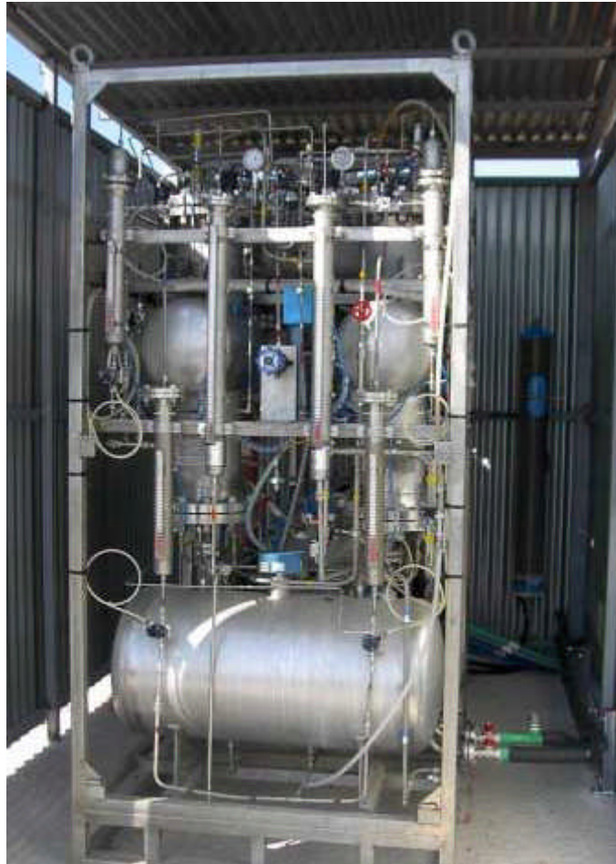
Εικόνα 1. Η αλκαλική μονάδα ηλεκτρόλυσης 25 kW στο Αιολικό πάρκο του ΚΑΠΕ.
