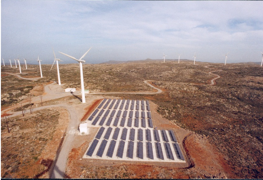
Εικόνα 2.2: Φ/Β Σταθμός συνολικής εγκατεστημένης ισχύος 172 kWp της ΡΟΚΑΣ ΑΙΟΛΙΚΗ ΑΒΕΕ στο Νομό Λασιθίου
