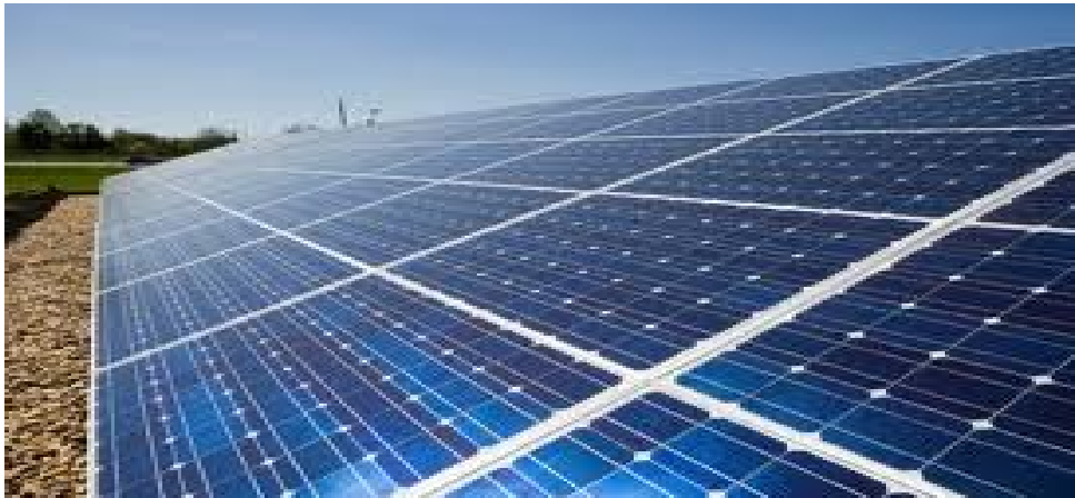
Εικόνα 3.26 Φ/Β σταθερού άξονα
