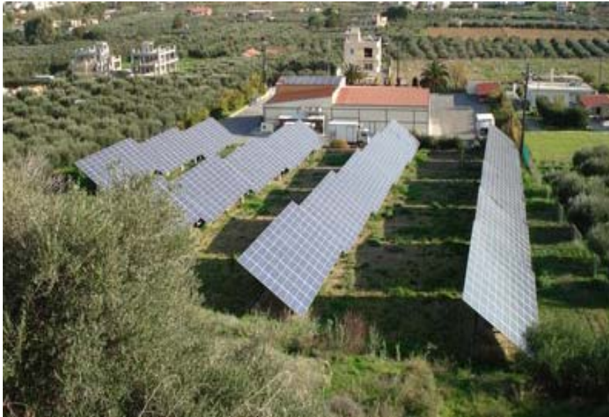
Εικόνα 2.3: Φ/Β Σταθμός συνολικής εγκατεστημένης ισχύος 135 kWp στο Νόμο Ηρακλείου
