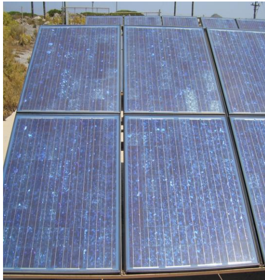
Σχ.6.2 Τα φωτοβολταϊκά πλαίσια πολυκρυσταλλικού πυριτίου που αποτελούν το πάρκο.
