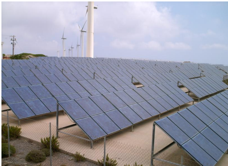
Σχ.6.5 Οι συστοιχίες του φωτοβολταϊκού πάρκου. Αποτελούμενες η κάθε μια από δύο σειρές με δώδεκα φωτοβολταϊκά πλαίσια η κάθε μία (συνολικής ισχύος 2,88 kWp).
