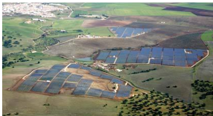
Σχ.2.15 Μεγάλο Διασυνδεδεμένο φωτοβολταϊκό πάρκο στο δίκτυο (11MW), στην Serra της Πορτογαλίας.
