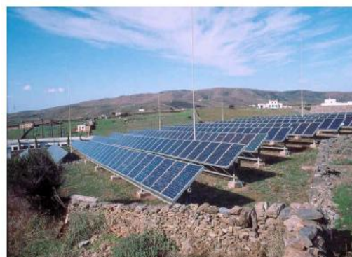
Σχ.1.2 Φ/Β Πάρκο της ΔΕΗ στην Κύθνο (1983) 100 kWp.
