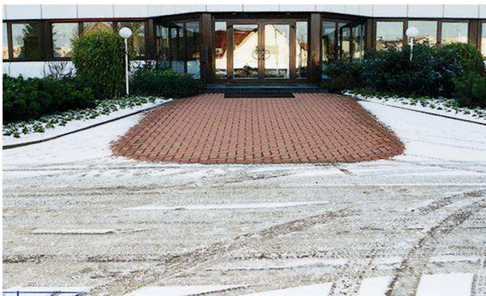
Εικόνα 16 Τοποθέτηση σε εξωτερικό χώρο με σκοπό την αποφυγή δημιουργίας πάγου.
