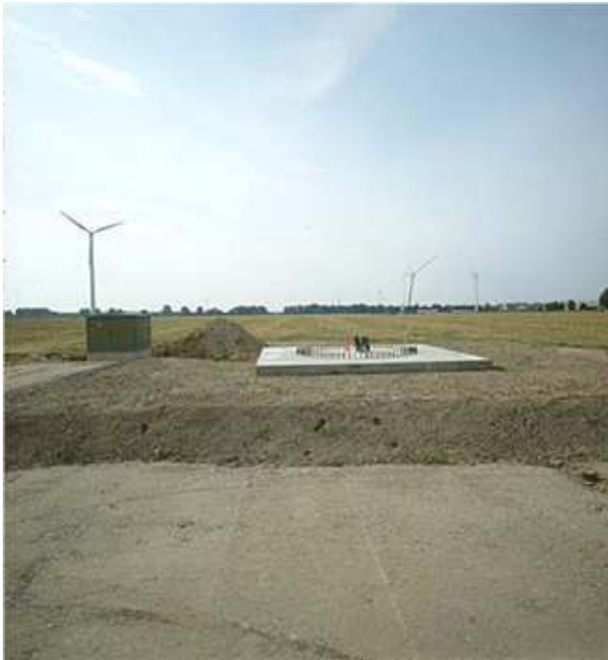
Εικόνα 3.13: Διαμόρφωση πλατείας γύρω από την Ανεμογεννήτρια
