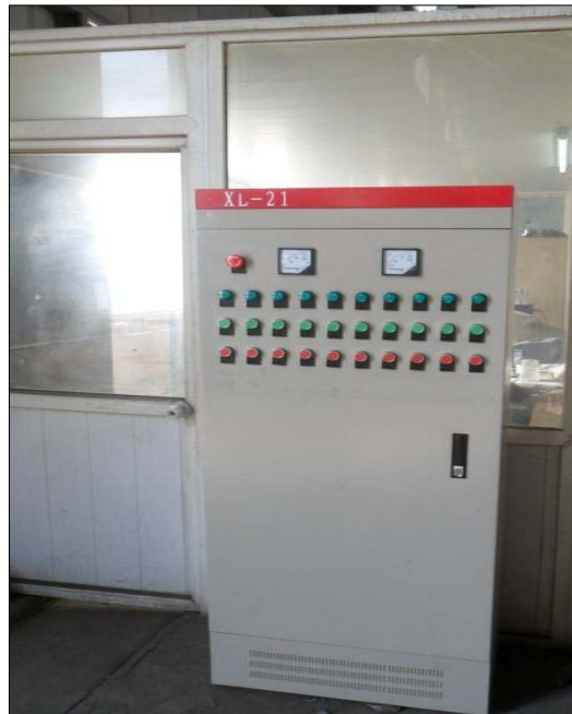
Εικόνα 4.8: Ηλεκτρικός Πίνακας Ελέγχου (Electric Cabinet).
