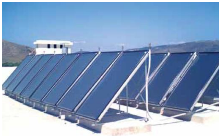
Εικόνα 4.2: Συστοιχία ηλιακών συλλεκτών για παραγωγή ζεστού νερού επί επίπεδης οροφής [22]
