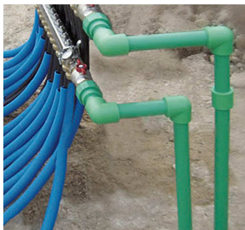
Εικόνες 16. Συλλέκτες προπυλενίου (PP-R) προσαγωγής και επιστροφής υγρού συνδεμένες με σωλήνες πολυαιθυλενίου (PE) οριζόντιας γεωθερμίας.
