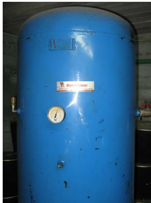
Εικόνα 4. Χώρος αποθήκευσης αέρα
