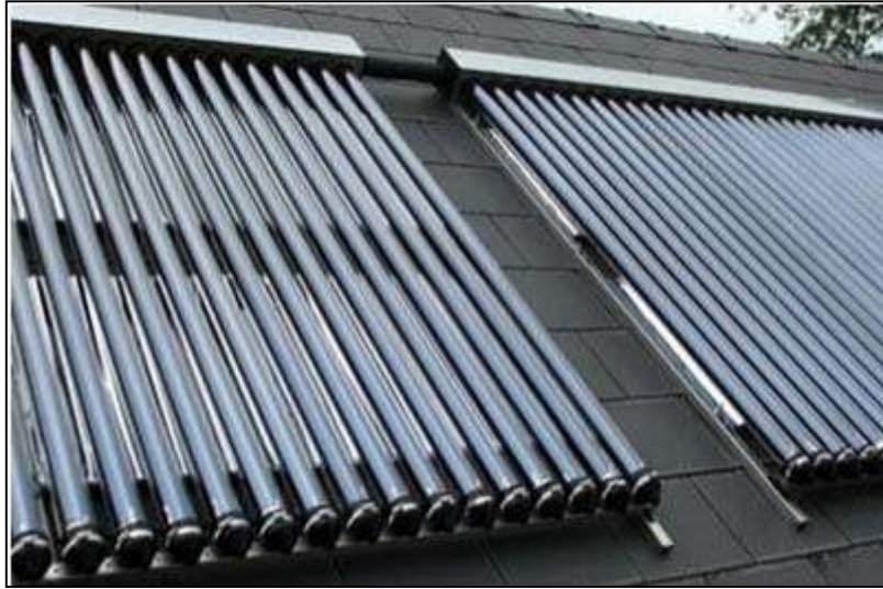
Εικόνα 52. Ηλιακοί σωλήνες κενού. Έχουν κυρίως εφαρμογή σε βιομηχανικά κτίρια.
