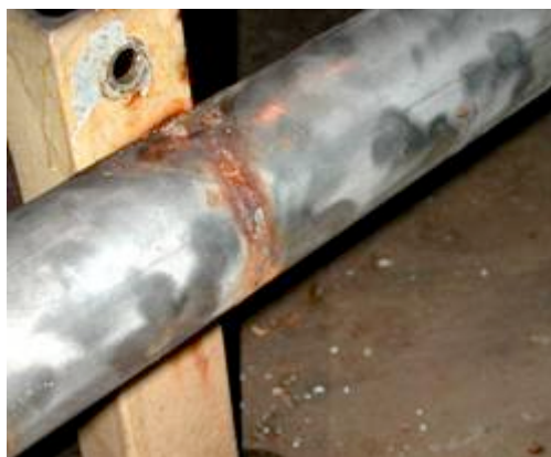
Εικόνα 4.4 : Διάβρωση διάκενου ή Χαραγής
