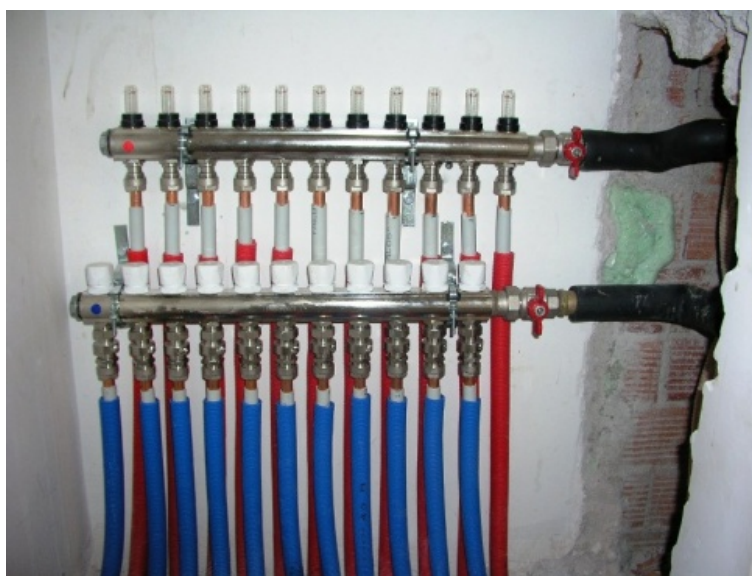
Εικ.1.4: Διανεμητής προσαγωγής - επιστροφής κεντρικής θέρμανσης.
