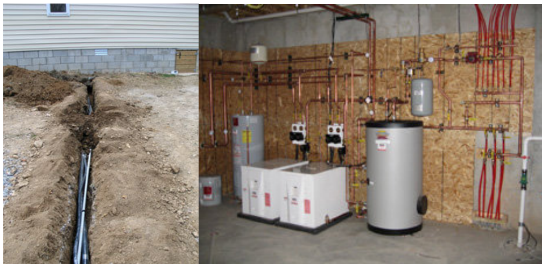
Εικόνα 6.22 Σωληνώσεις που κατευθύνονται από τον πολλαπλό συλλέκτη στο χώρο του μηχανοστασίου. Εικόνα 6.23 Τοπική απεικόνιση μηχανοστασίου Γ.Α.Θ. σε μικρής κλίμακας εφαρμογές.
