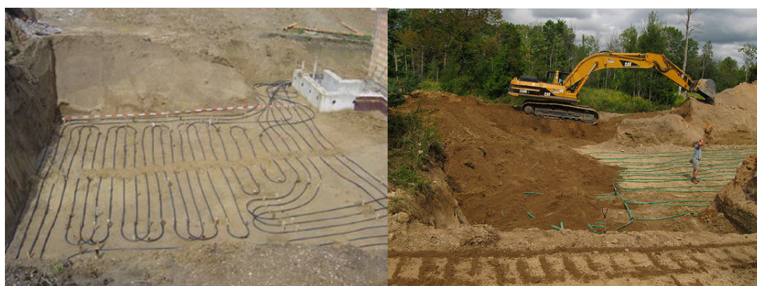
Εικόνες 4.4.2.2 Τοποθέτηση στρώσεων σωληνώσεων σε οριζόντια διάταξη σε εκσκαφές ολικής απομάκρυνσης του εδάφους.
