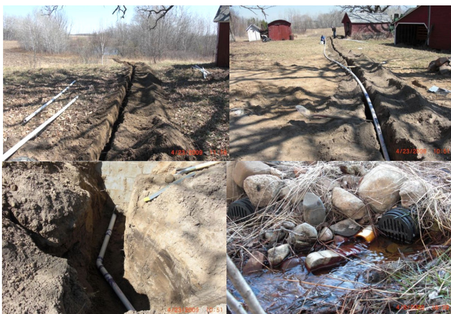
Εικόνες 4.2.3.1 Εγκατάσταση ανοικτού συστήματος με άντληση και απόθεση νερού από επιφανειακά νερά (λίμνη), σε κατοικία στη Minnesota των Η.Π.Α.. Στη τελευταία εικόνα βλέπουμε το σημείο επιστροφής του νερού στη λίμνη. (πηγή: Strandlund Refrigeration Heating & Cooling, LLC)
