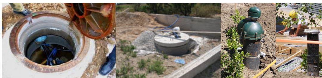
Εικόνες 4.2.1.3 Φρεάτιο γεώτρησης σε σύστημα ανοικτού κυκλώματος σε κατοικία στην Αττική. (πηγή: Κ.Α.Π.Ε.) Εικόνες Κεφαλή γεώτρησης εξαγωγής και γεώτρησης επανέγχυσης σε κατοικία στο Burlington των Η.Π.Α.. (πηγή: OnlyNeverIn Sweden.blogspot). Παρατηρούμε και στις δύο περιπτώσεις τον ελάχιστο χώρο που καταλαμβάνουν στο οικόπεδο.
