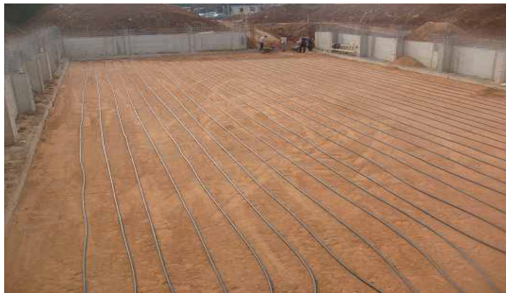
Εικόνα 4.4.4.1.1 Τοποθέτηση σωληνώσεων οριζόντιου γεωεναλλάκτη σε προετοιμασμένη επιφάνεια κάτω από το χώρο θεμελίωσης του κτιρίου. (Σπύρος Ν. Παπασπύρου, Στρώσεις εξυγίανσης και βοηθητικές στρώσεις , 2011)
