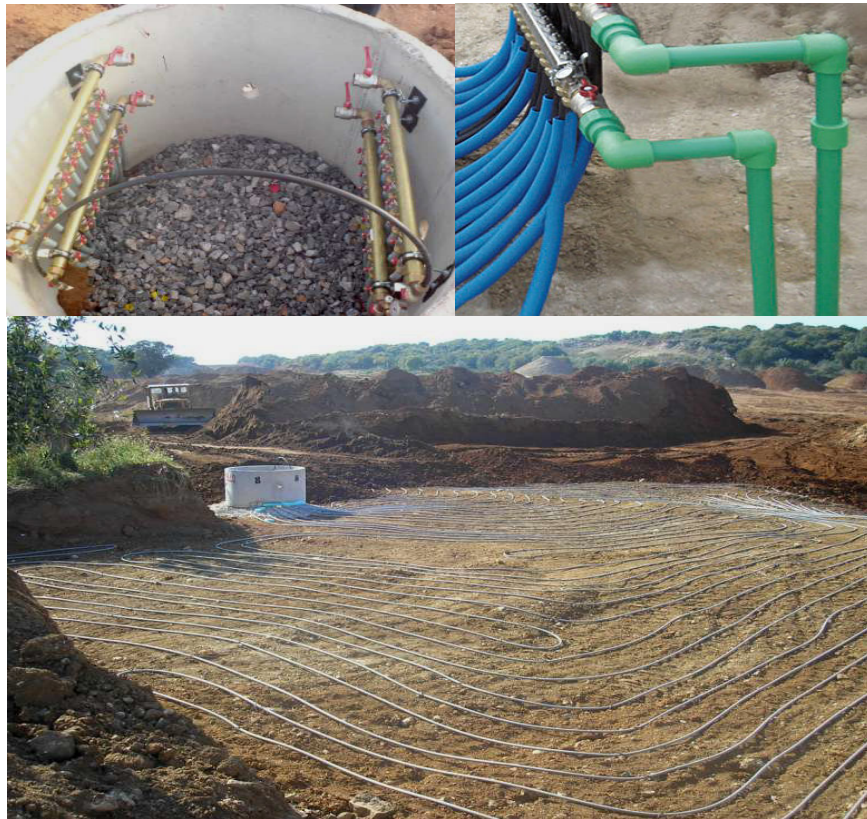
Εικόνες 6.16 Πολλαπλός σύνδεσμός (συλλέκτης) πριν και μετά την σύνδεση του με τις σωληνώσεις των βρόχων. Στην τελευταία εικόνα διακρίνουμε και την ελαφριά κλίση που δίνετε στις σωληνώσεις που καταλήγουν στον χώρο του συλλέκτη.
