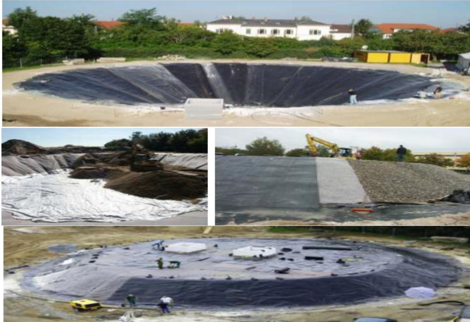
Κατασκευή της εποχιακής θερμικής αποθήκης χαλικιού –νερού σε λάκκο στο Eggenstein το 2007
