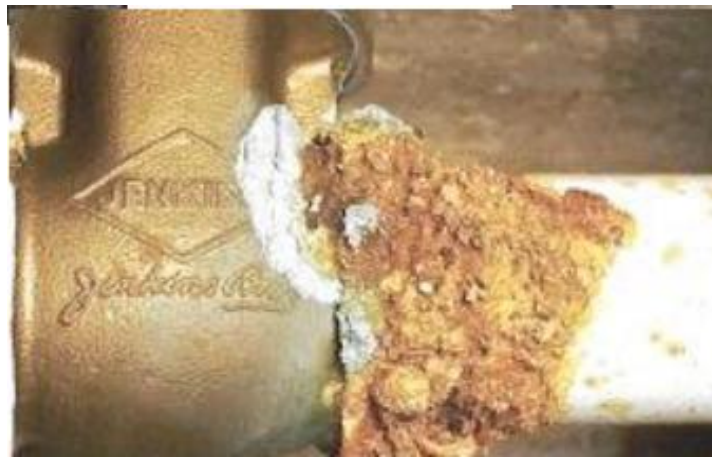
Γαλβανική διάβρωση σε δεξαμενές και σωληνώσεις
