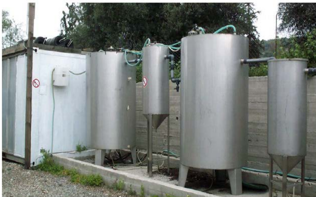
Πιλοτική μονάδα αναερόβιας επεξεργασίας κατσίγαρου (Βαμβακόπουλο Χανίων, Κρήτη)
