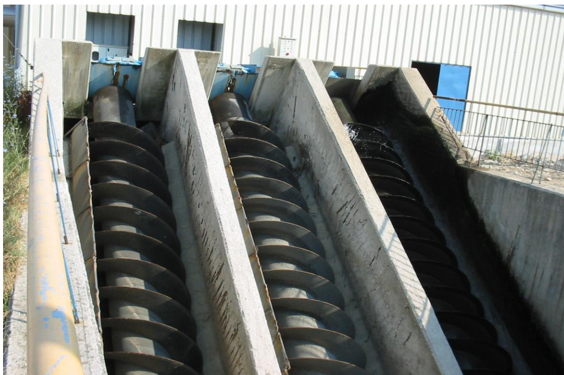
3. ΑΝΤΛΙΟΣΤΑΣΙΟ ΕΙΣΟΔΟΥ ΛΥΜΑΤΩΝ ( ΚΟΧΛΙΕΣ )
