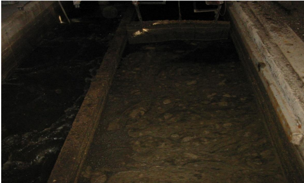
7. ΣΑΡΩΣΗ ΕΠΙΠΛΕΟΝΤΩΝ ΛΙΠΩΝ ΜΕ ΞΕΣΤΑ ΠΡΟΣ ΔΕΞΑΜΕΝΗ ΛΙΠΩΝ
