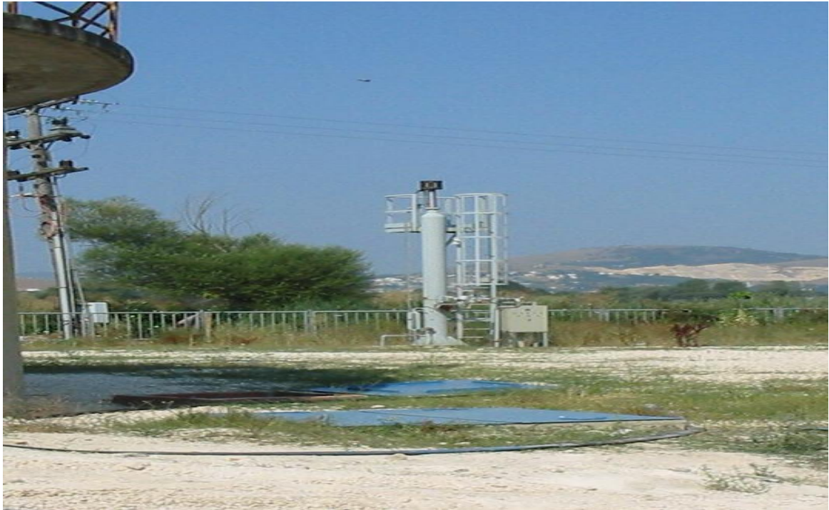
24. ΠΥΡΣΟΣ ΚΑΥΣΗΣ ΒΙΟΑΕΡΙΟΥ
