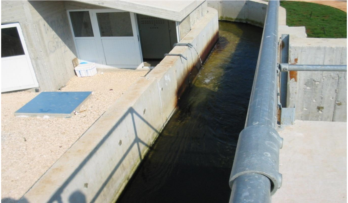
16. ΕΝΑΡΞΗ ΔΕΞΑΜΕΝΩΝ ΧΛΩΡΙΩΣΗ – ΑΝΤΛΙΑ ΧΛΩΡΙΩΣΗΣ
