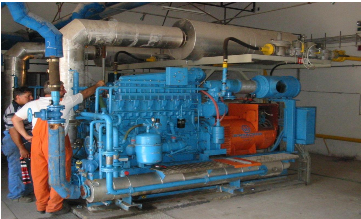
25. ΜΟΝΑΔΑ ΣΥΜΠΑΡΑΓΩΓΗ ΗΛΕΚΤΡΙΚΗΣ ΚΑΙ ΘΕΡΜΙΚΗ ΕΝΕΡΓΕΙΑΣ
