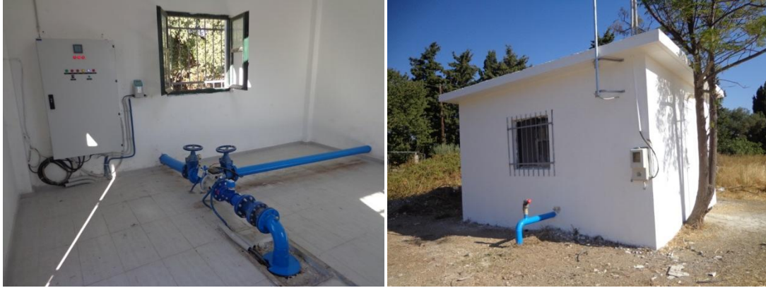
Σχ.5.1: Άποψη αντλιοστασίου (πηγή: Aegean News)
