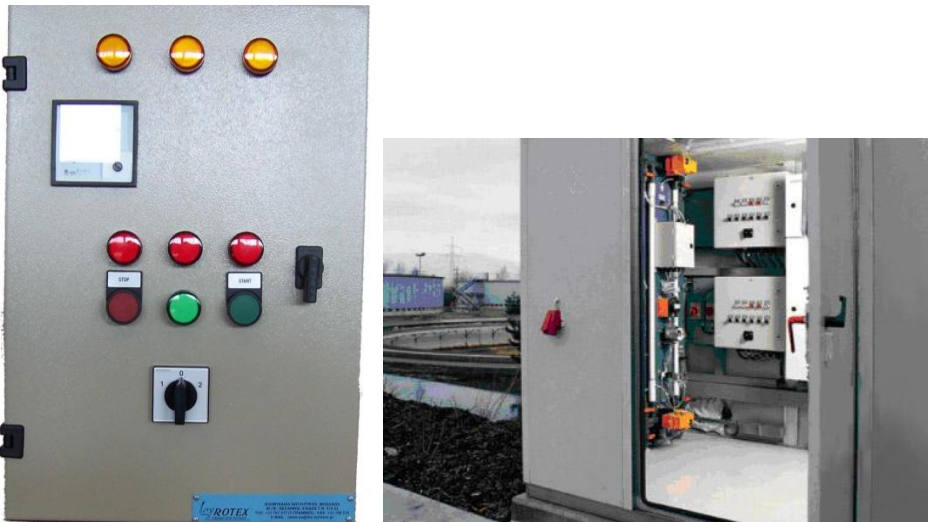
Σχ.5.2: Άποψη πίνακα αυτοματισμού (πηγή: Rotex (αριστερά), Vlachos (δεξιά))
