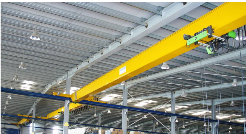
Εικόνα 3.3.4: Επικαθήμενη γερανογέφυρα μονού φορέα και με αναρτώμενο βαρουλκοφορείο
