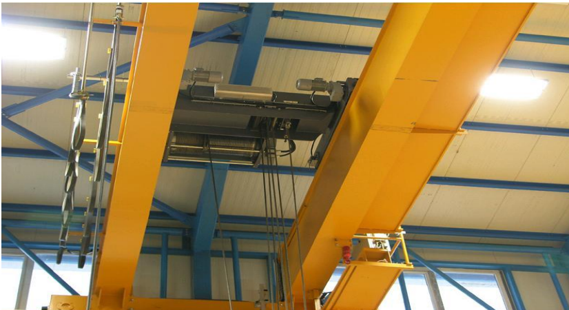
Εικόνα 3.3.5: Γερανογέφυρα διπλού φορέα με επικαθήμενο φορείο βαρούλκου
