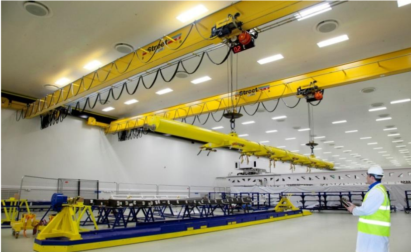
Εικόνα 3.3.3: Συστήματα γερανογέφυρας απλής κατανομής, με κοινές δοκούς κύλισης και με στήριξη οροφής
