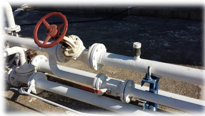
Εικόνα 31. Αγωγός μεταφοράς υγραερίου
