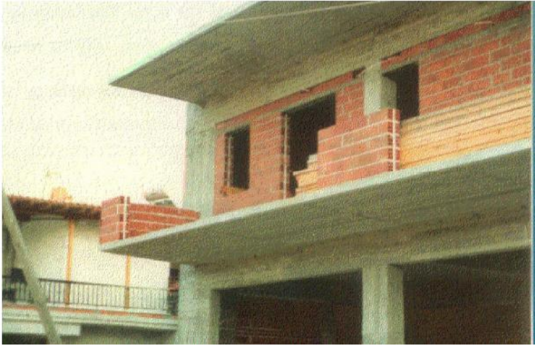
Εικόνα 5.1 : Ελλιπής -και αντιφατική- εφαρμογή θερμομόνωσης (1994): Ταδοκάρια και τα τοιχεία δεν μονώνονται. Αντίθετα, έχουν μονωθεί τα στηθαία του μπαλκονιού.
