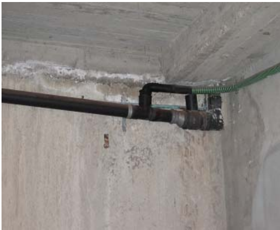
Κεντρικό αποχετευτικό δίκτυο
