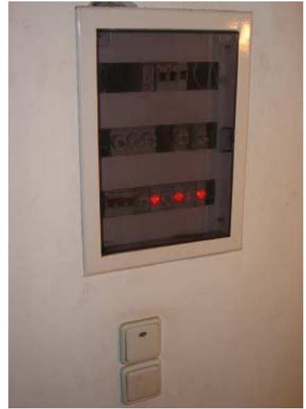
Κοινόχ. ηλεκ. εγκατ. (κλιμακοστάσιο)
