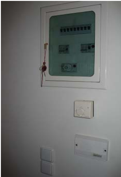
Ηλεκτρικές εγκαταστάσεις διαμερίσματος
