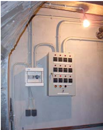
Κοινόχ. ηλεκ. εγκατ. (Λεβητοστάσιο)
