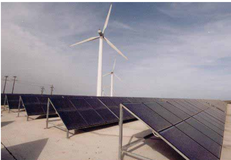
Οι παραπάνω φωτογραφίες είναι από το φ/β πάρκο της ΡΟΚΑΣ ΑΙΟΛΙΚΗ ΑΒΕΕ στο Νομό Λασιθίου , ισχύος 171.6 kWp.
